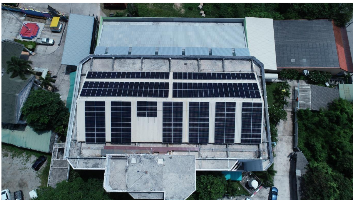
ภาพที่ 10 แสดงระบบผลิตไฟฟ้าด้วยโซลาร์เซลล์ทั้งระบบเดิมและระบบใหม่รวม 72 กิโลวัตต์ บนหลังคาอาคารตึกผู้ป่วยในของโรงพยาบาลจะนะ
