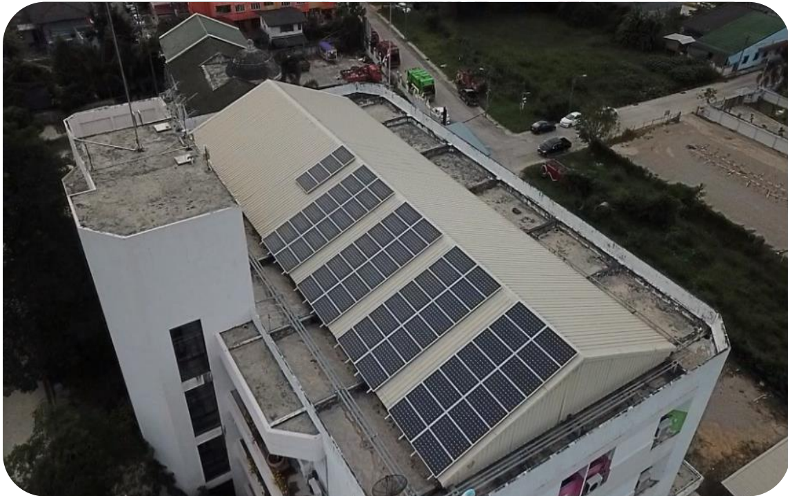
ภาพที่ 7 แสดงหลังคาที่ติดตั้งแผงโซลาร์เซลล์ขนาด 20 kW ของโรงพยาบาลจะนะ และทางโรงพยาบาลมีแผนที่จะติดตั้งให้ครอบคลุมพื้นที่หลังคาคือ 60 kW ในปี 2562
